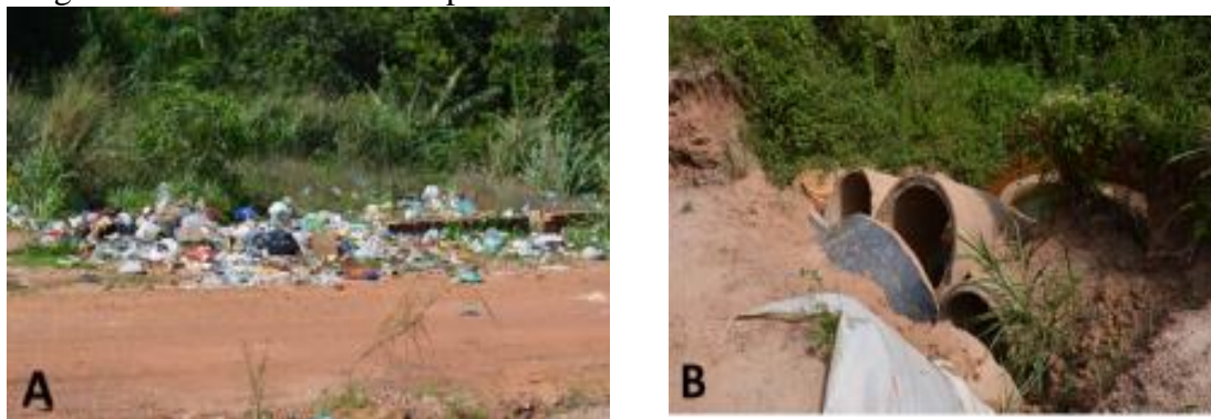
Figura 8 - Resíduos sólidos e processo erosivos localizados na sub bacia do Batatã.
